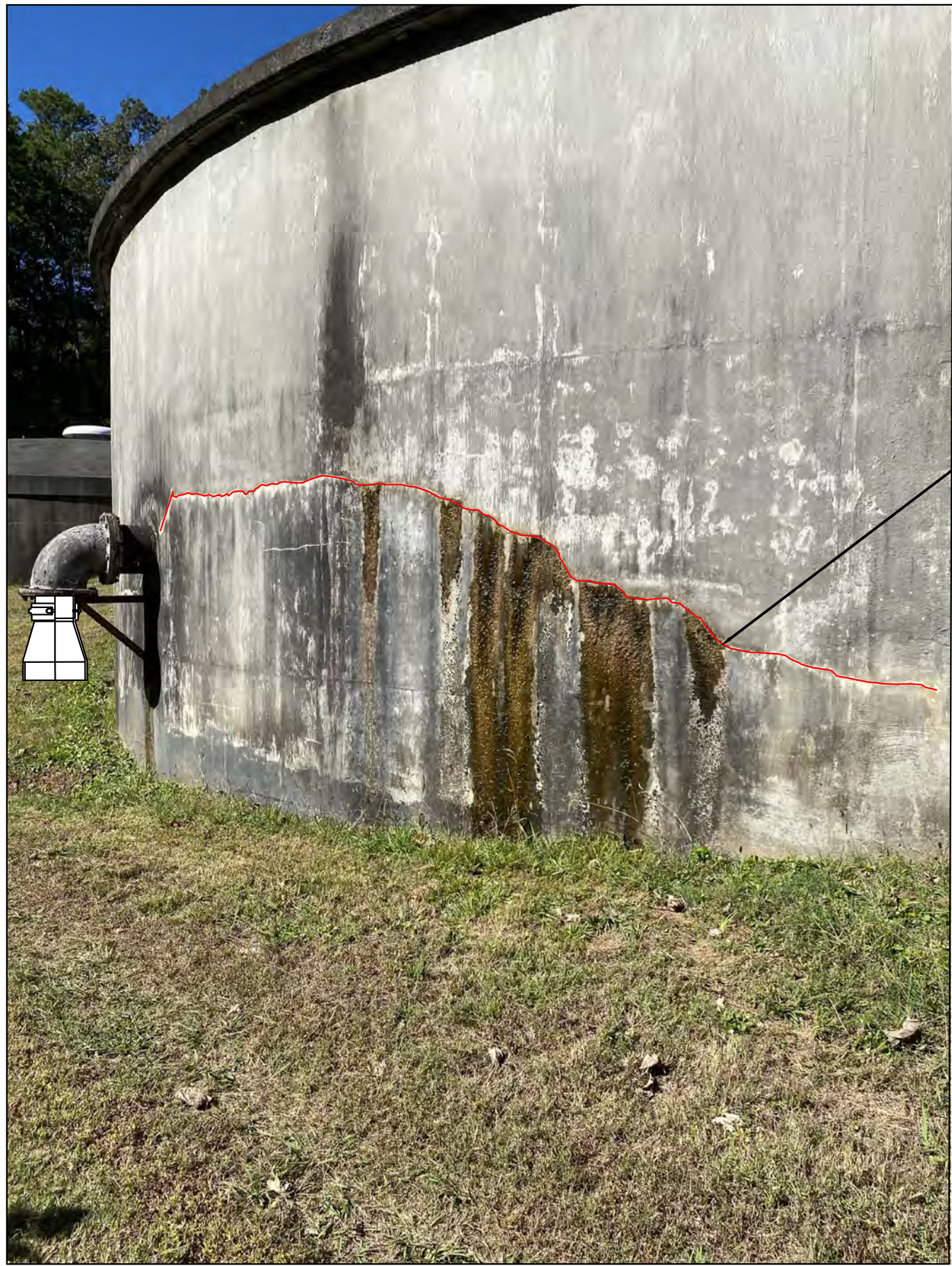
2 CRACK IN CLEARWELL CONCRETE SCALE: N.T.S.
